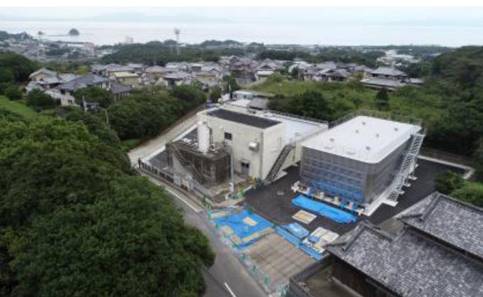
新安中配水池
