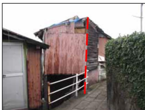
一部の柱が傾斜している例
