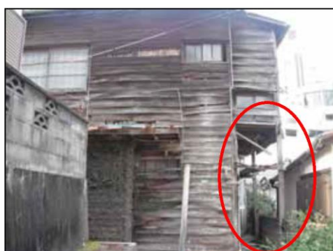
柱の数箇所に破損がある例
