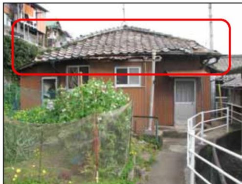
屋根に不陸がある例
