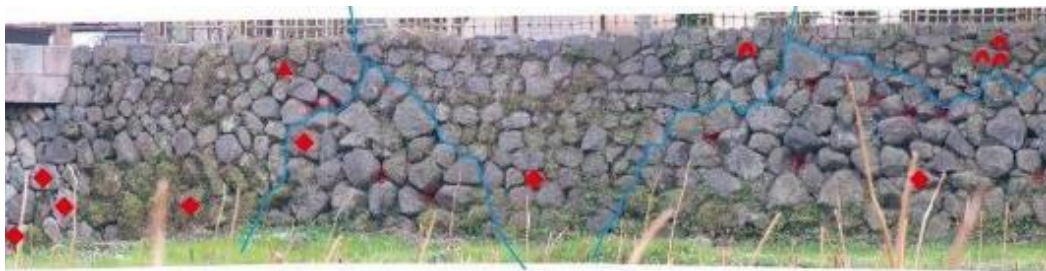
石垣カルテ事業で確認された積直しライン（青線）
