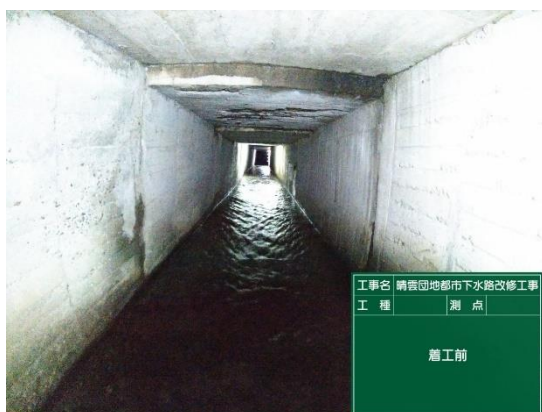
都市下水路内の劣化状況・鉄筋露出腐食状況
