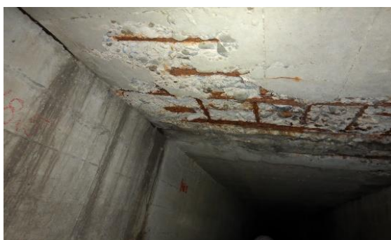
都市下水路内の劣化状況・鉄筋露出腐食状況
