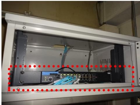
(L2 フロアスイッチ：各フロアに設置)
