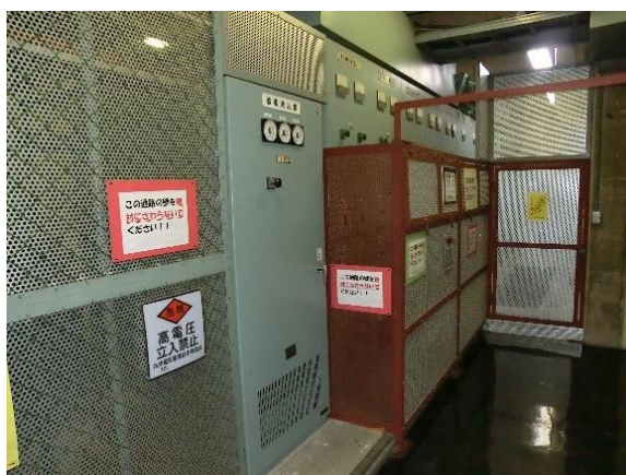
<島原文化会館高圧受電設備>
