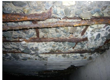
鉄筋露出腐食状況
