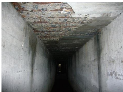
都市下水路内の劣化状況
