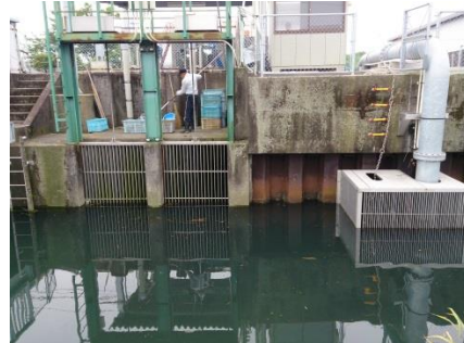
(潮遊び側) 大型排水ポンプ
