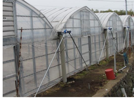
〔自動換気施設〕
