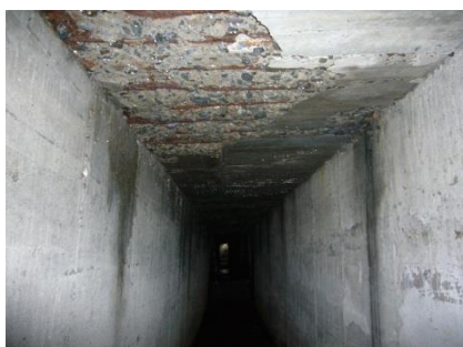
都市下水路内の劣化状況
