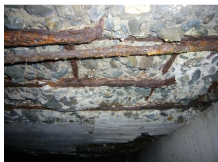
鉄筋露出腐食状況
