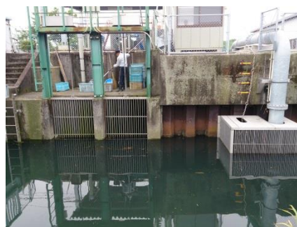
(潮遊び側) 大型排水ポンプ
