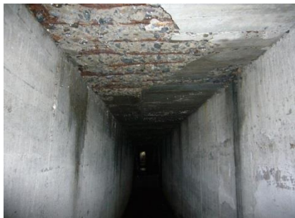
都市下水路内の劣化状況
