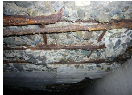
鉄筋露出腐食状況
