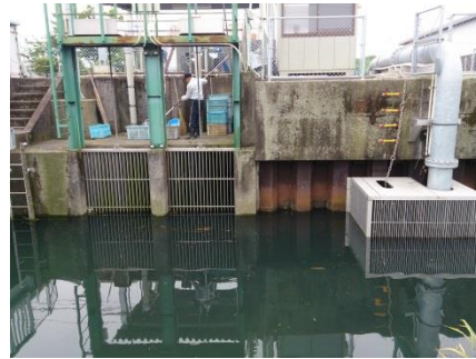
(潮遊び側) 大型排水ポンプ
