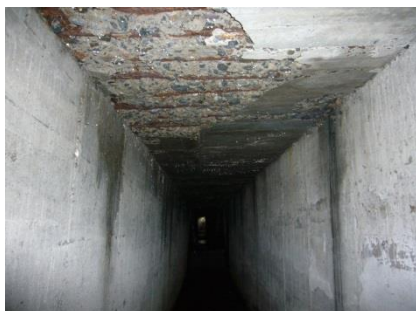
都市下水路内の劣化状況
