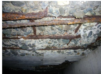
鉄筋露出腐食状況
