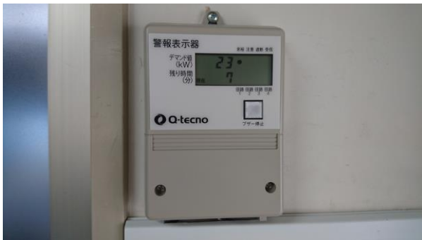
<デマンドコントロール装置>
