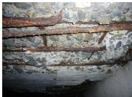
鉄筋露出腐食状況
