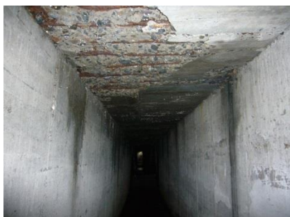
都市下水路内の劣化状況
