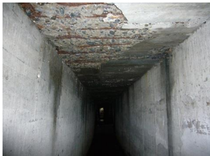
都市下水路内の劣化状況
