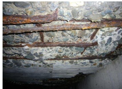
鉄筋露出腐食状況
