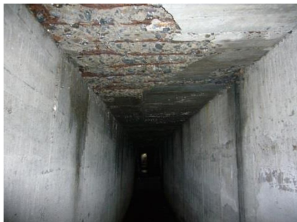
都市下水路内の劣化状況
