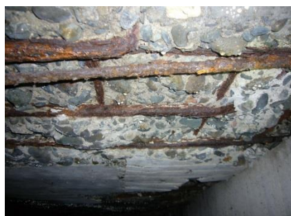
鉄筋露出腐食状況
