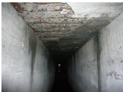
都市下水路内の劣化状況
