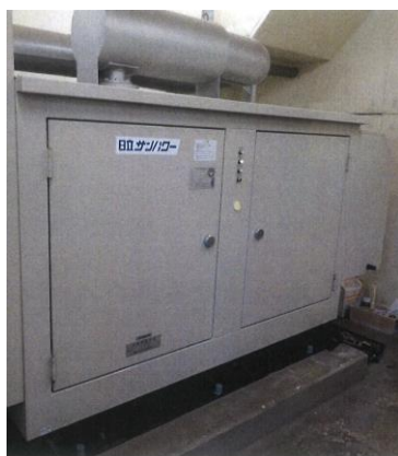
[非常用発電機]
