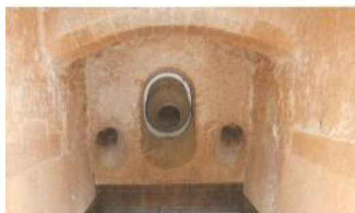
[2号炉バーナーコンバスター炉内部]
