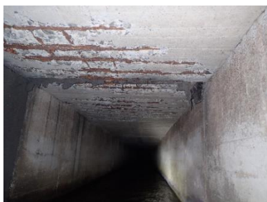
都市下水路内の劣化状況
