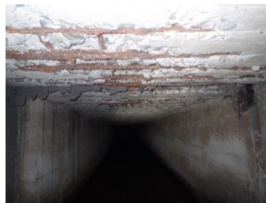
鉄筋露出腐食状況
