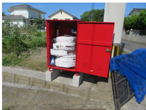
ホース格納箱 (青葉町)
