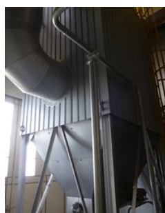
[バグフィルター外観]
