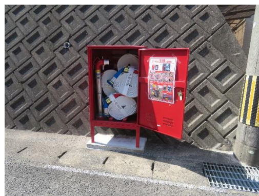
ホース格納箱 (新湊二丁目)
